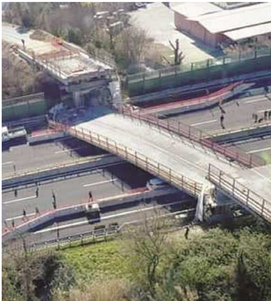
Ad Ancona il crollo di un ponte sull'autostrada A14 ha causato la morte di due coniugi che sono andati a sbattere violentemente contro le macerie. Feriti anche tre operai che stavano eseguendo i lavori
